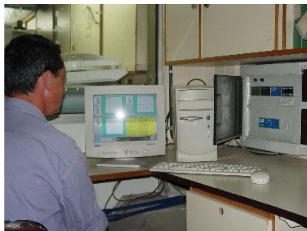
Figura1. Puesto de monitoreo y control en el sector de guardia técnica.
